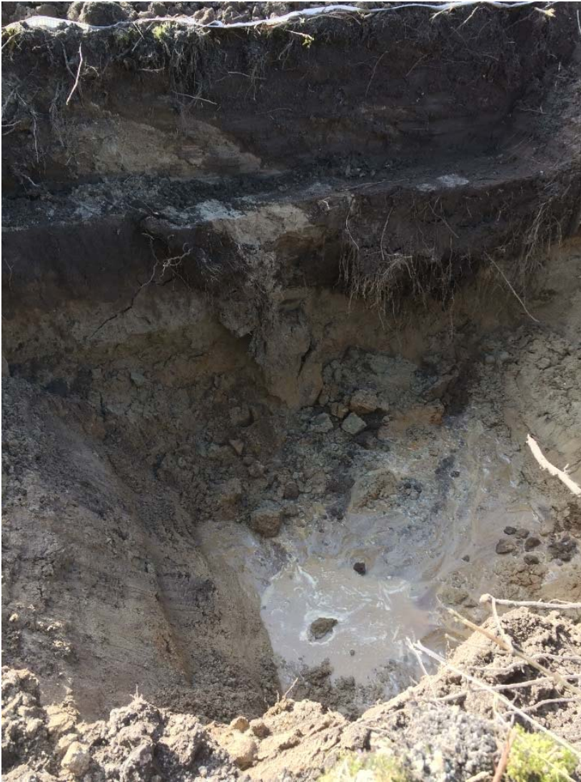
Figur 3: Grop område B där väggar börjat rasa in. Foto taget mot väster.
