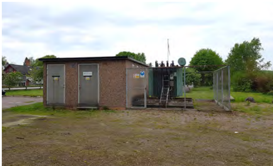
Bild 5. Befintlig transformatorstation, Röstångavägen till vänster i bilden.
